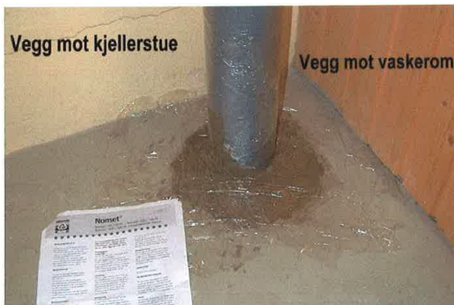
9. Øverste 10 cm. av hullet tettet med "Nonset" ekspanderende mørtel. (Plastfolien er der for å unngå sprekkdannelse under herdingen). I følge fagfolk og produsent er denne mørtelen tett.
