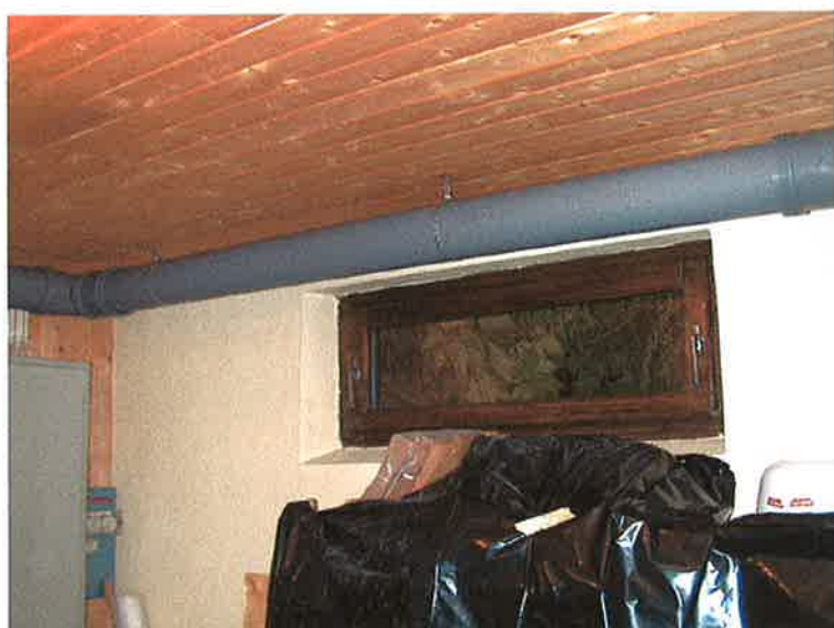
8. Rør fra hjørne, mot ventil.
